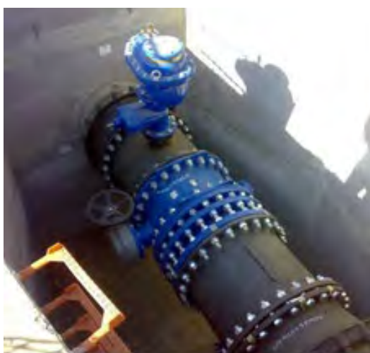
Détail du tuyau principal
