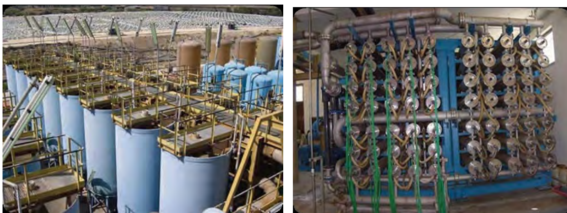
Priolo (Syracuse) usine de traitement de l'eau potable.
