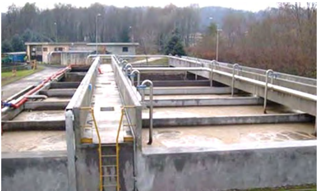
Usine de d'épuration de Borgomanero (Novara)
