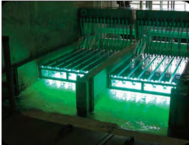
Usine de traitement des eaux usées de Savone
