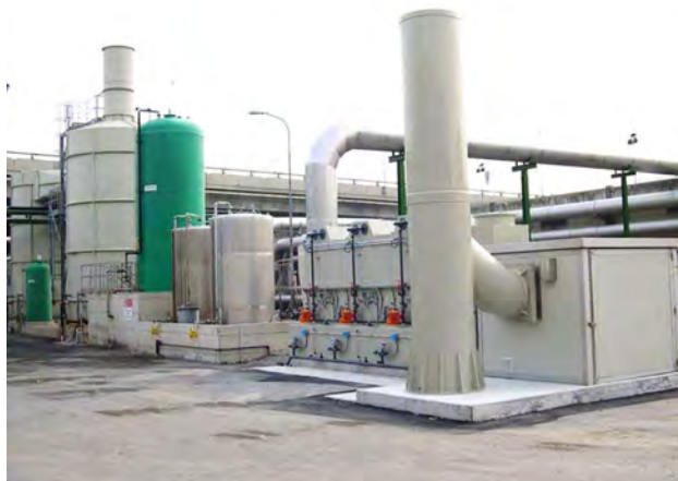
Usine de d'épuration de Finale Ligure (Savone): usine de désodorisation
